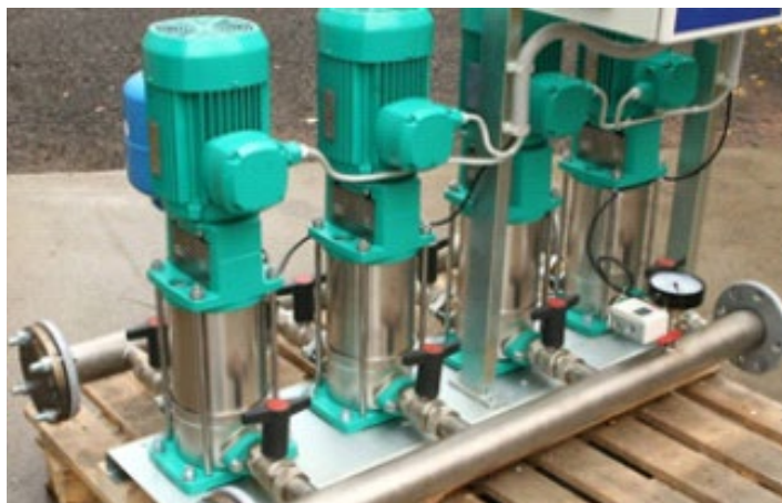
Насосная станция из четырех насосов
