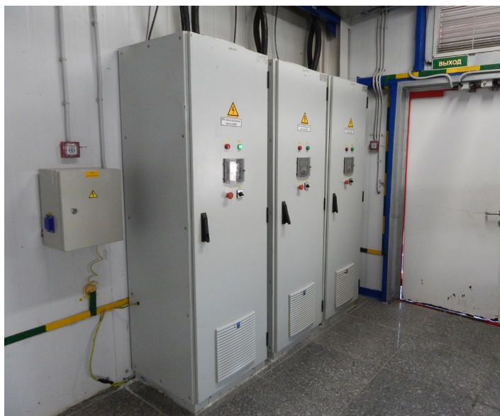
Шкафы управления насосами
