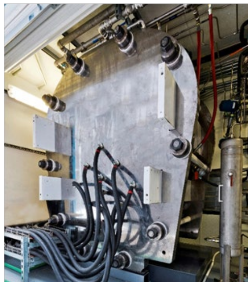
Рис 5. Электролизер EL-N в контейнерном исполнении
