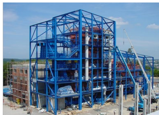
Паровой котел для ТЭЦ с горизонтальной компоновкой для загрязненного топлива
